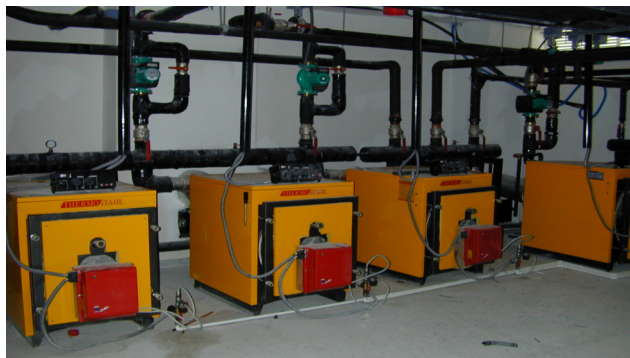
Εσωτερική άποψη ημιυπόγειου (λεβητοστάσιο)
